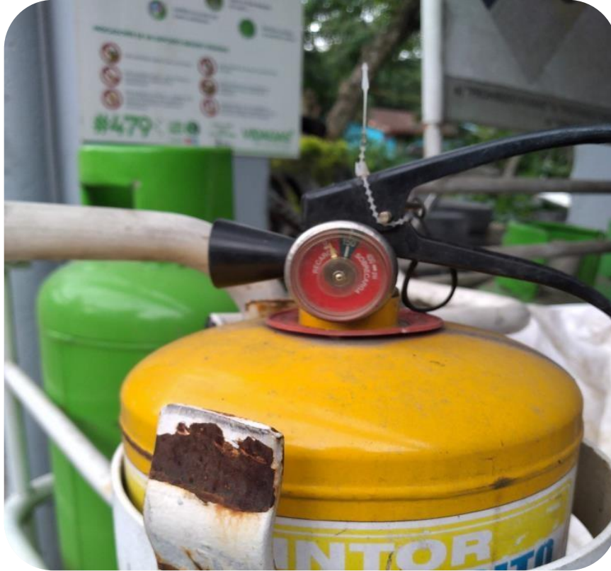
Extintores vencidos o deteriorados
