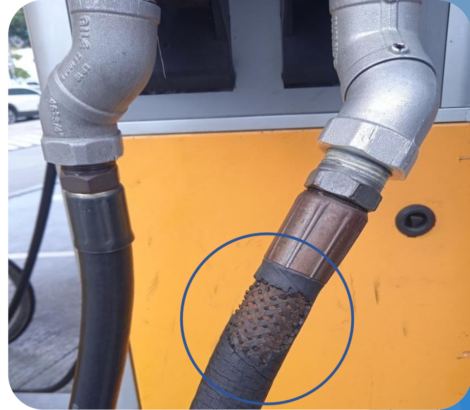
Equipos o Dispositivos Avariados o Falta de Mantenimiento
