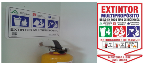
Señalización o ubicación adecuada de extintores
